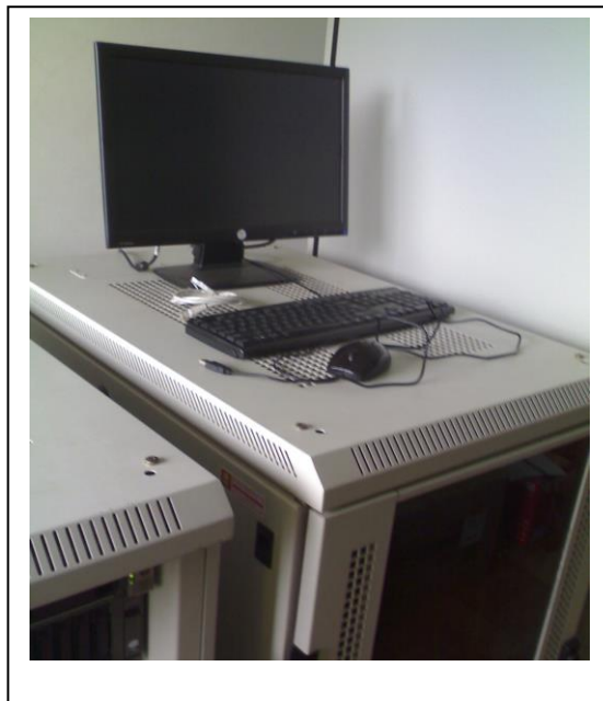
Gambar 3.2 Foto server Kantor PDT Kabupaten Bantul Yogyakarta
