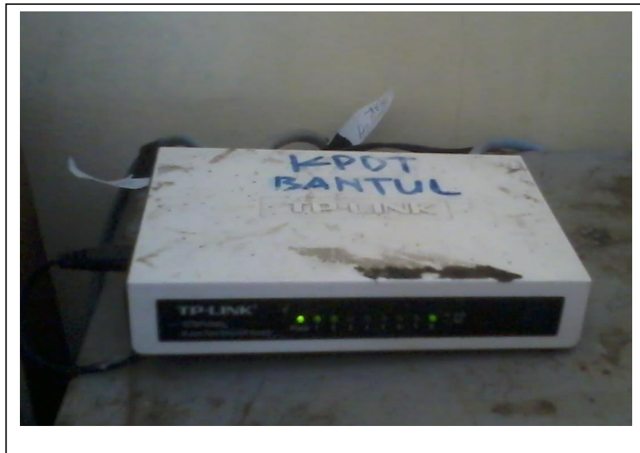
Gambar 3.62 Foto Switch Hub saat penambahan jaringan LAN di Kantor Kecamatan Imogiri
