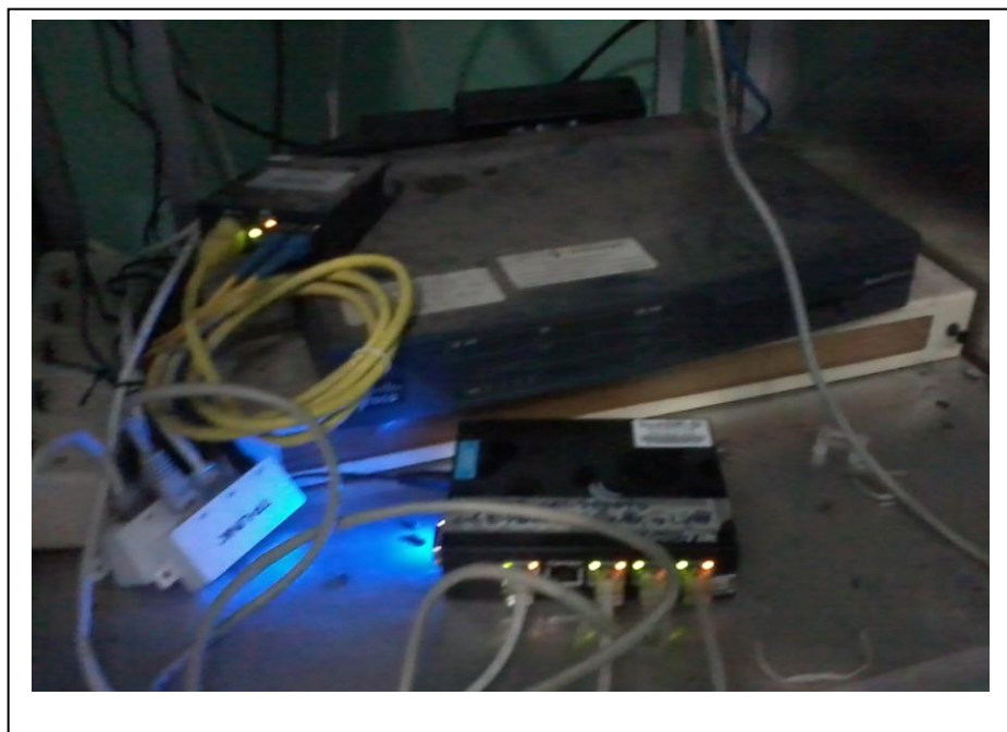
Gambar 3.49 Foto Router dan Switch Hub di Kantor Kecamatan Sedayu Bag.SIAK
