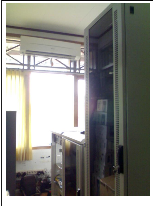
Gambar 3.2 Foto server Kantor PDT Kabupaten Bantul Yogyakarta
