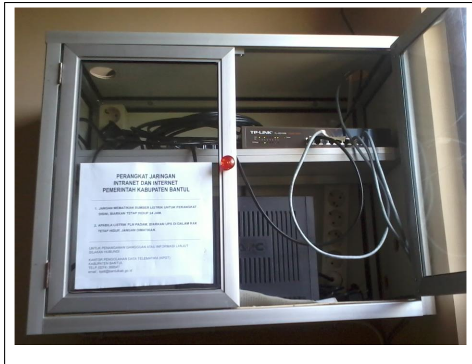
Gambar 3.35 Foto Router dan Switch Hub saat penambahan jaringan LAN di Kelurahan Srigading
